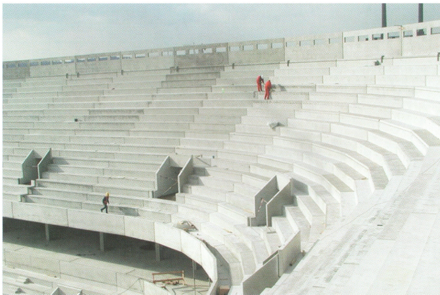
Рис. 7. Элементы из самоуплотняющегося бетона (LC25/28 D1,6) с высококачественными поверхностями для верхнего и нижнего ограждений верхней трибуны стадиона Фольксваген-Арена в Вольфсбурге (Фото: Liapor)
